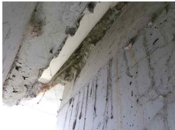
S3 파손 및 철근노출(0.2×1.0)
