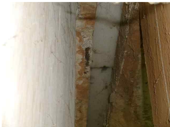
S3 파손 및 철근노출(0.3×1.0)
